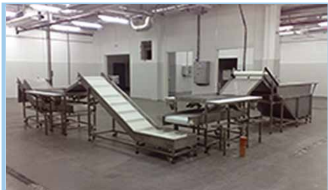
Конвейерные линии для рыбной продукции с модульной лентой и рабочими столами для переработки охлажденной рыбы
