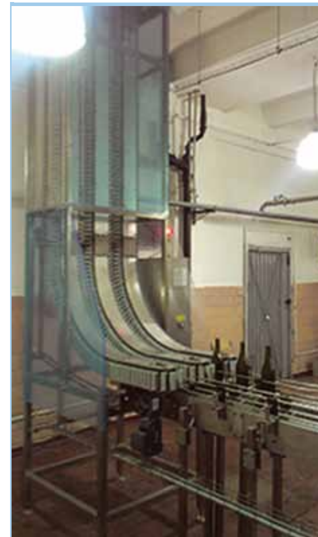
Грипперная конвейерная система для межэтажного и многоуровневого перемещения штучных грузов
